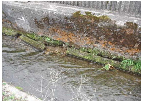
劣化による用水路側壁の破損
